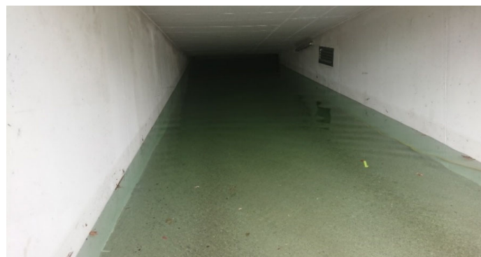
Vollgelaufene Tiefgarage (Unterm Berg 40)
